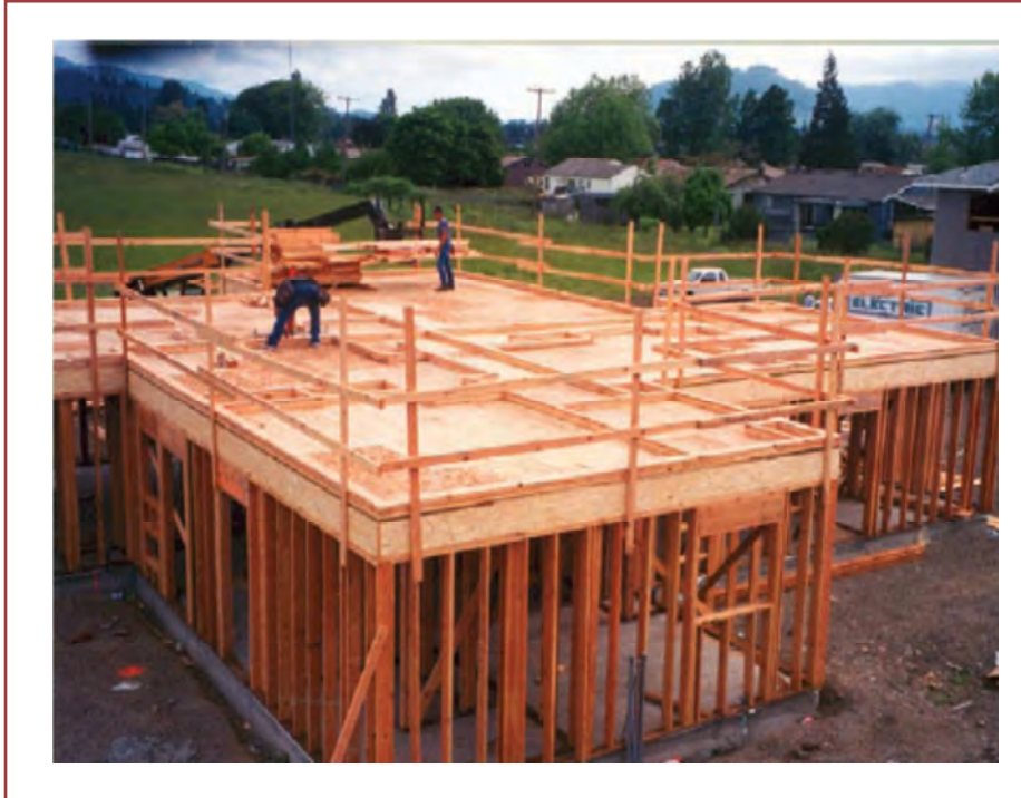
شکل ۴۶ - سیستم های نرده حفاظتی موقت که حفاظت کارگران را از سقوط تسهیل می کند.
